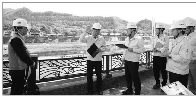
노창환 무주군수 권한대행과 관계 공무원, 토목 분야 민간 전문가로 구성된 민관 합동점검반이 남대천교 보수·보강 공사 현장을 찾아 집중 점검을 벌였다.
