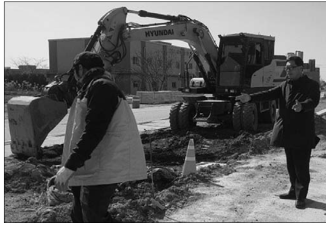
익산시 송학동 한국타이어 티스테이션부터 지안리자아파트까지의 학곡선 (총길이 820m), 4차선 도로확포장공사가 당초 계획된 공사기간보다 앞당겨 개통된다.
