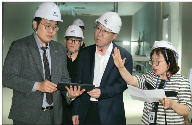
우범기 전주시장은 27일 수소놀이체험관 건립 현장을 찾아 시설물 전반의 진행 상황과 현장 안전을 꼼꼼하게 점검했다.
