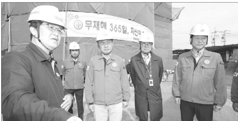
최근 전북 지역에서 중대재해가 잇따라 발생하고 있어 중대재해 예방을 위해 지난 26일 도립국악원 증개축 공사현장을 찾은 김관영 전북특별자치도지사가 건설현장의 안전관리 실태를 점검하고 있다.
