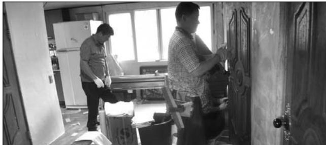
순창군이 소외 계층의 열악한 주거환경개선을 위해 추진하고 있는 저소득 계층 노후주택 개·보수사업이 주민들로부터 큰 호응을 얻고 있다.
